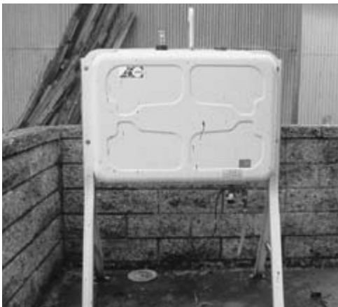
ホームタンク
