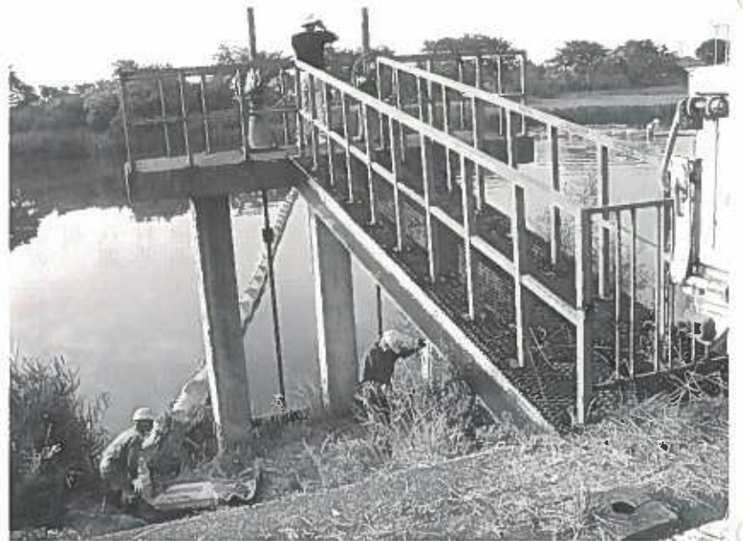
昨年、上水道取水口へオイルフェンスを設置している様子
