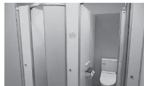
回転扉型の新設トイレ
