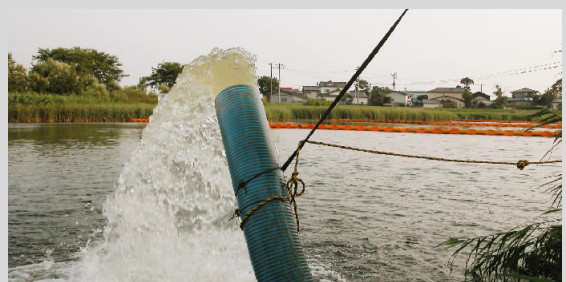
取水口に取り付けられた仮設噴水装置
