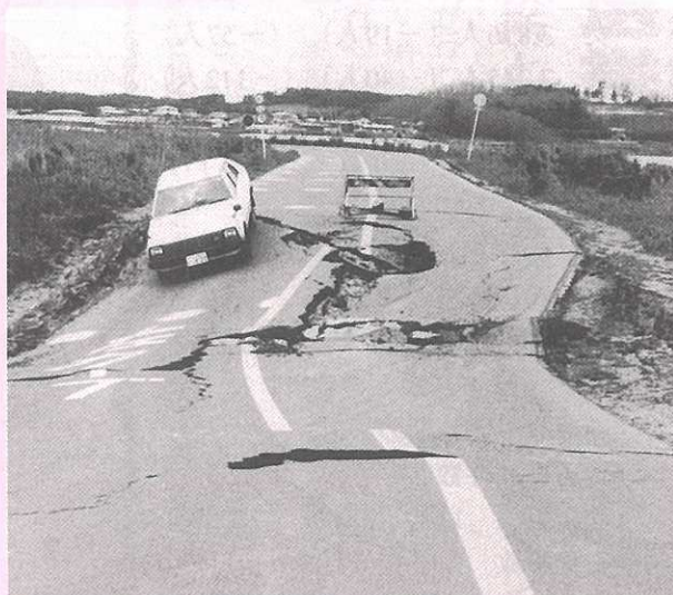
D アメのように曲がって亀裂と陥没が生じた八郎潟干拓道路。
