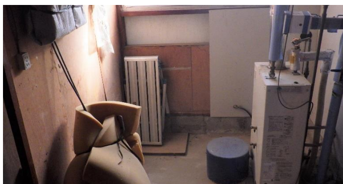
③⑪ ボイラー室
